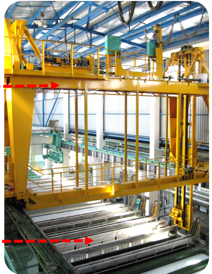
Hệ thống cầu văng tự động di chuyển nhôm qua từng hồ xử lý
