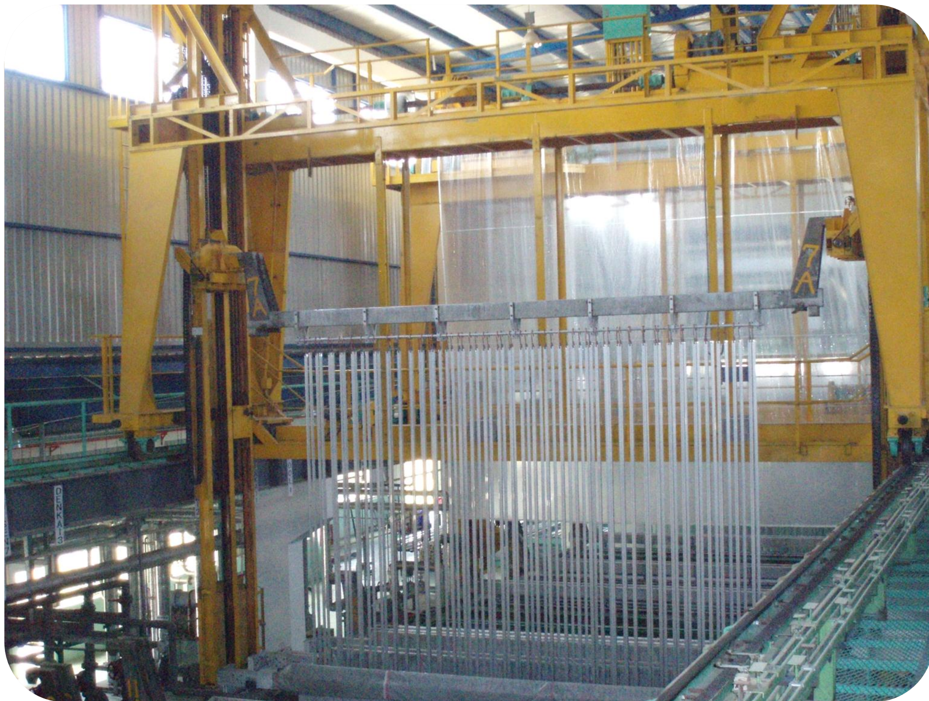
Dây chuyền xử lý bề mặt hoàn toàn tự động – CÔNG NGHỆ THĂNG ĐỨNG
